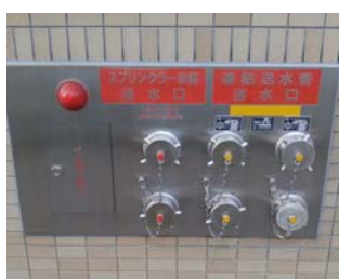
写真2 連結送水管送水口 12
